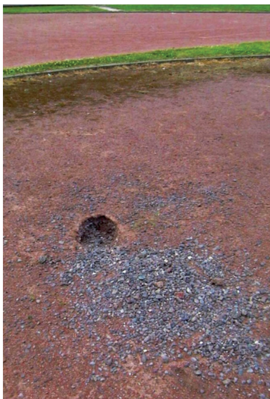
Abb. 84: Wühl Schäden durch Kaninchen
