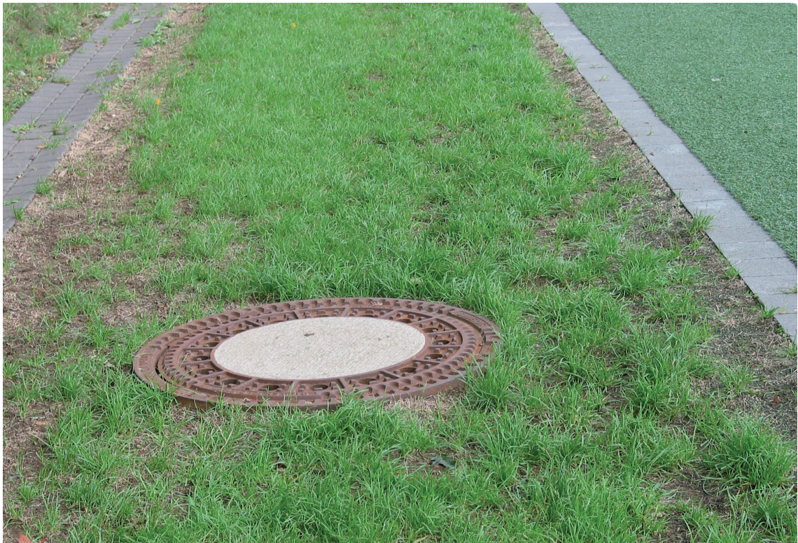
Abb. 11: Schachtdeckel innerhalb des hindernisfreien Raumes
