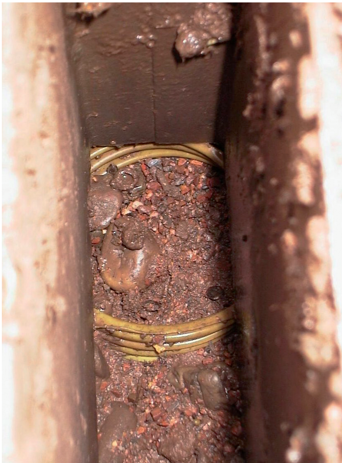
Abb. 86: Einlaufkasten mit verstopftem Dränrohr
